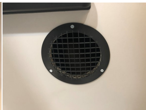
Ansaugöffnung für kalte Luft
