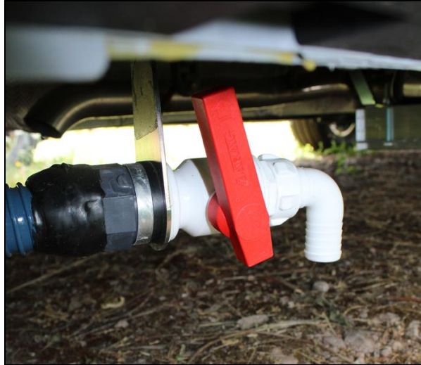
Ablassventil Abwasser (Abb. beispielhaft)
