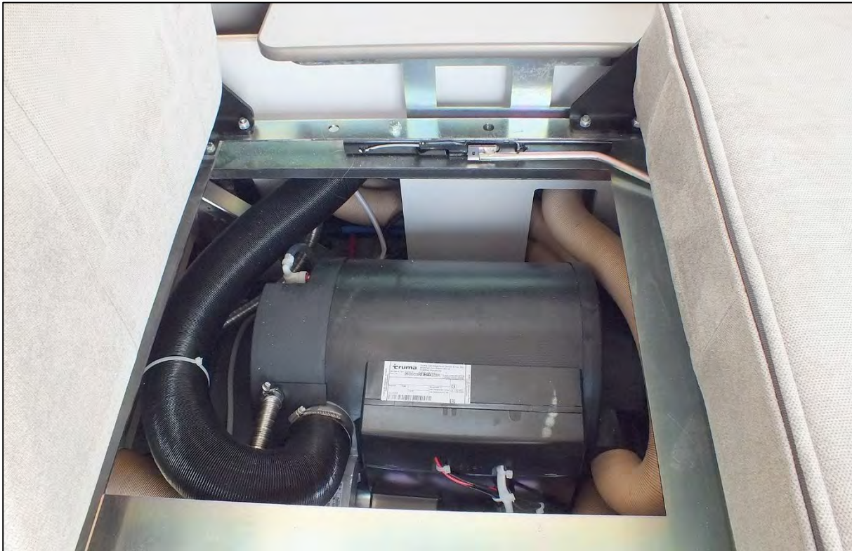
Heizungsanlage im Sitzkasten der Sitzbank beim Dexter 550 (Abb. beispielhaft)
